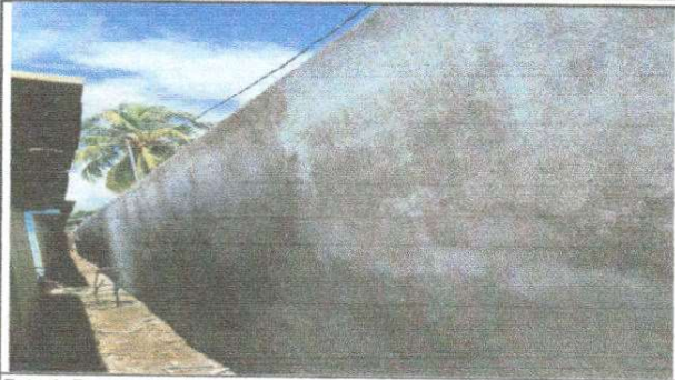
Foto 1: Reparación de muro perimetral, debido a que no existe un refuerzo para sostener el muro y corre el riesgo de caer.
